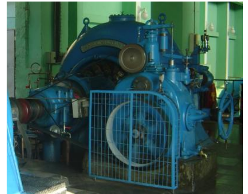
Turbina con regulador de velocidad mecánico
