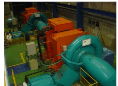
Casa de maquina n°2
